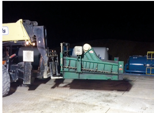
Retirada de la zaranda Derrick* HyperPool*
